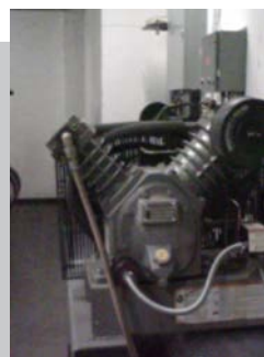
Compresor de aire – 100% visible
